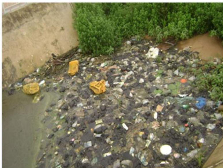
Photo 1 : Déchets jetés dans le caniveau
