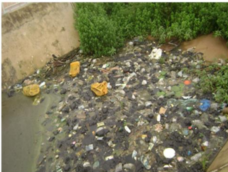
Photo 1 : Déchets jetés dans le caniveau
