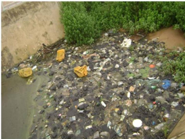
Photo 1 : Déchets jetés dans le caniveau
